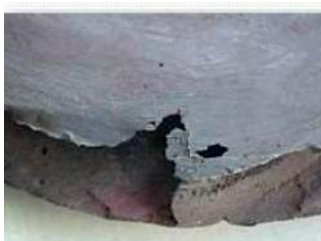
Corrosión por cavitación
