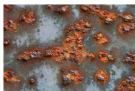
Corrosión del acero inoxidable.
